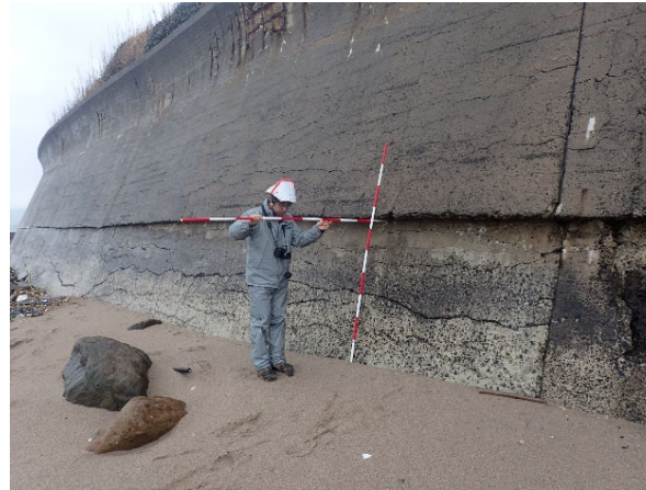
護岸のはらみ出しを確認
