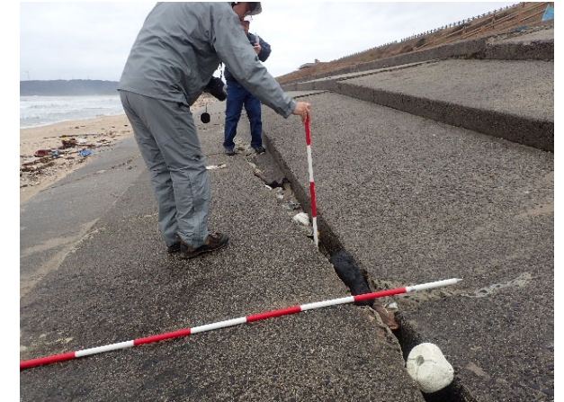
護岸のひび割れ・空洞を確認
