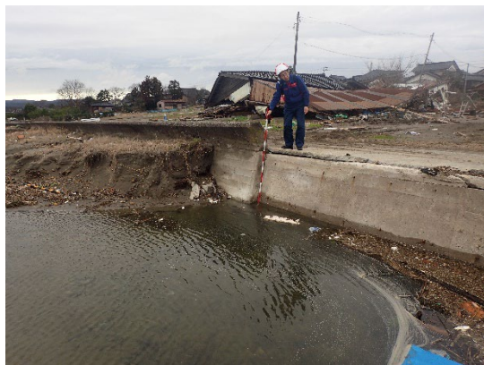
護岸の波返工の流失状況を確認
