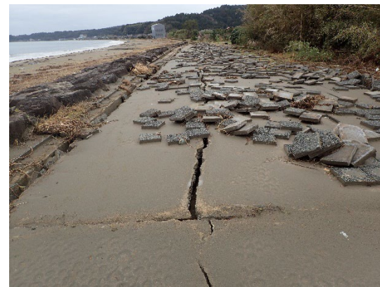
護岸の天端被覆工のひび割れとずれ
