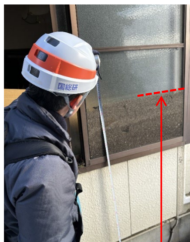
浸水した痕跡からの浸水深の把握（1月14日・珠洲市）
