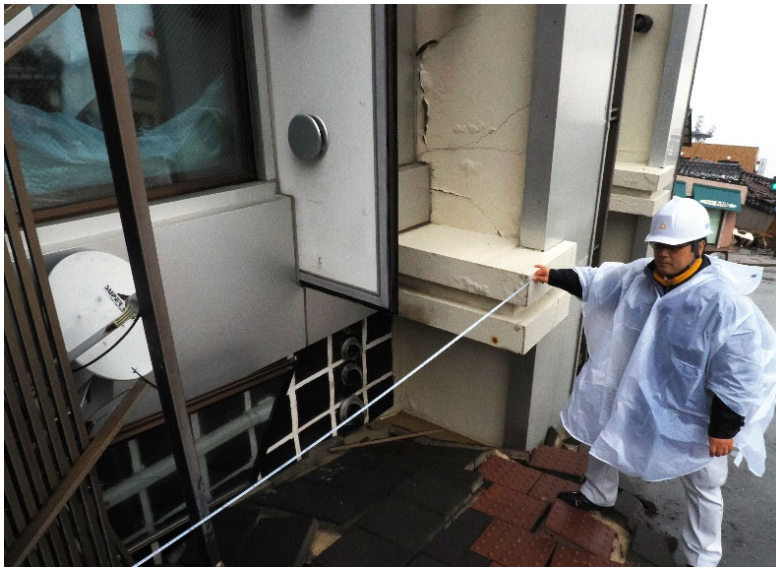
RC造建築物の被害状況の把握調査 (1月10日輪島市)
